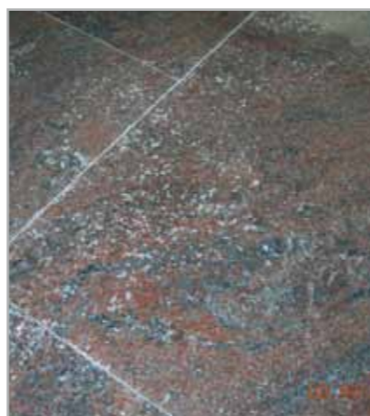
Fig. 2.7 - Esempio di efflorescenze legate a risalita di umidità dal sottofondo
