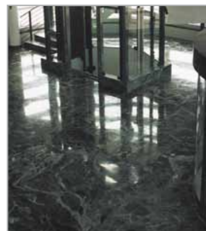
Fig. 4.9 - Esempio di posa di pavimento in marmo Verde Alpi con KERALASTIC - Hall Rolex - Bienne - Svizzera
